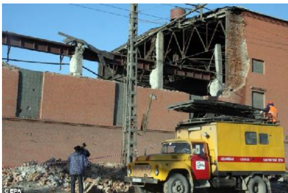
Skader på Zinkværket
